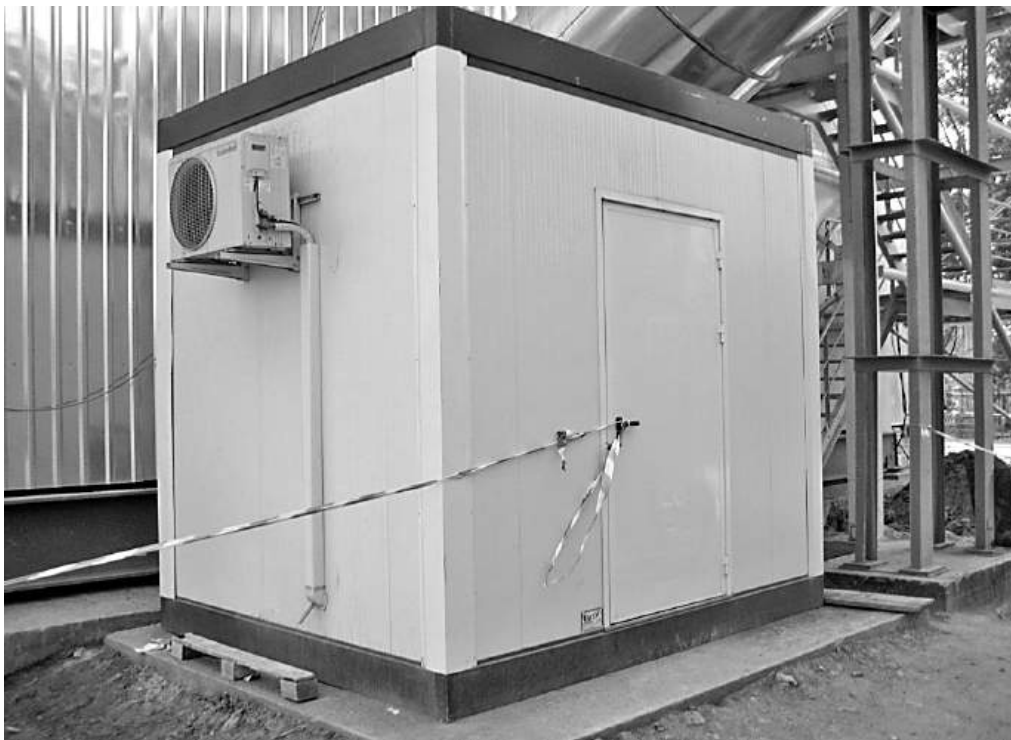
Рис. 4.5 АПС на базі всепогодного блок-контейнера
